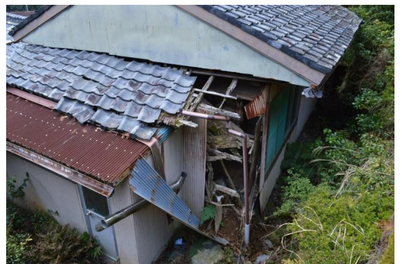
倒壊箇所あり (外側)
