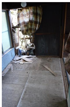
倒壊箇所あり (内側)
